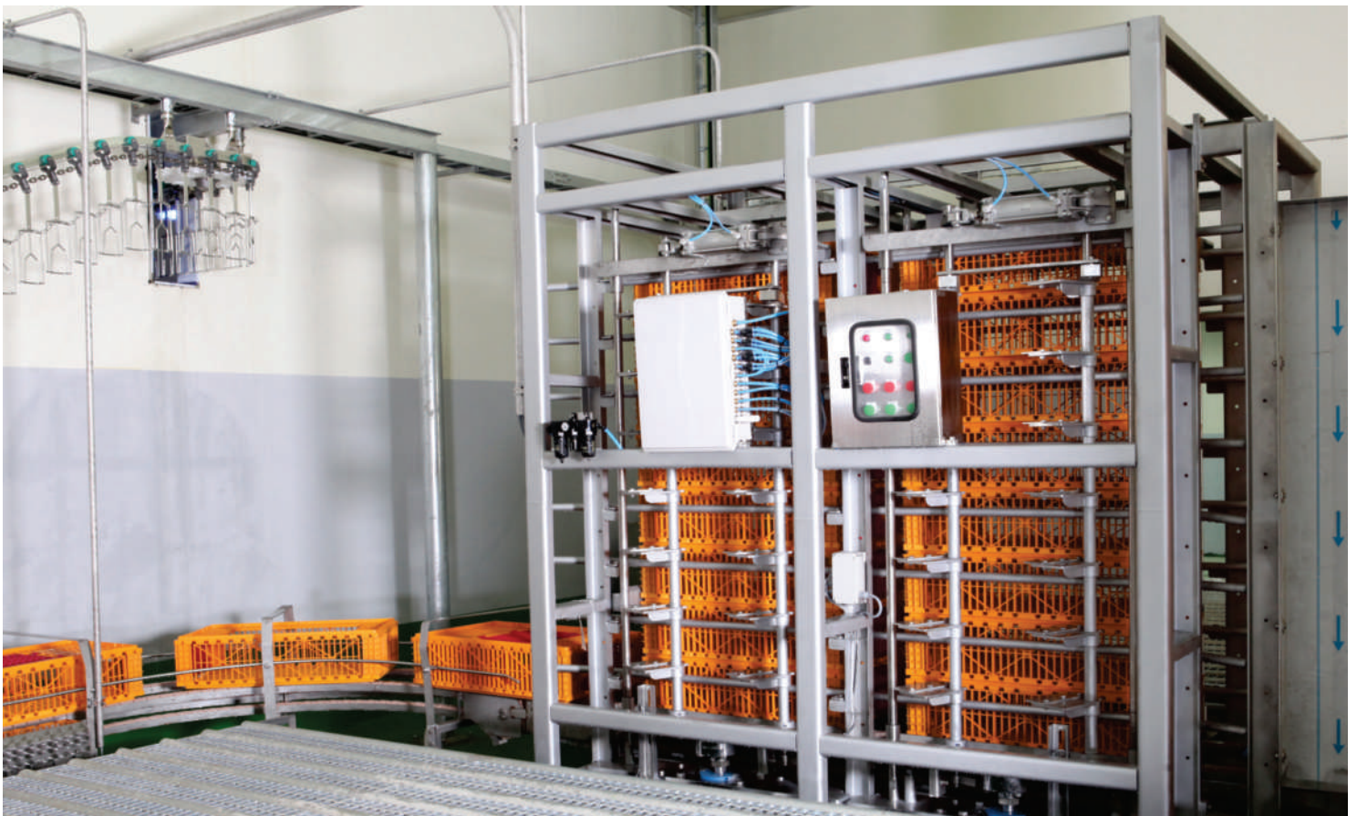
Equipos automáticos para la recepción y sacrificio de aves tales como: Sistema Automático para Descarga de Jaulas, Mesa Giratoria para Colgado de Pollo
