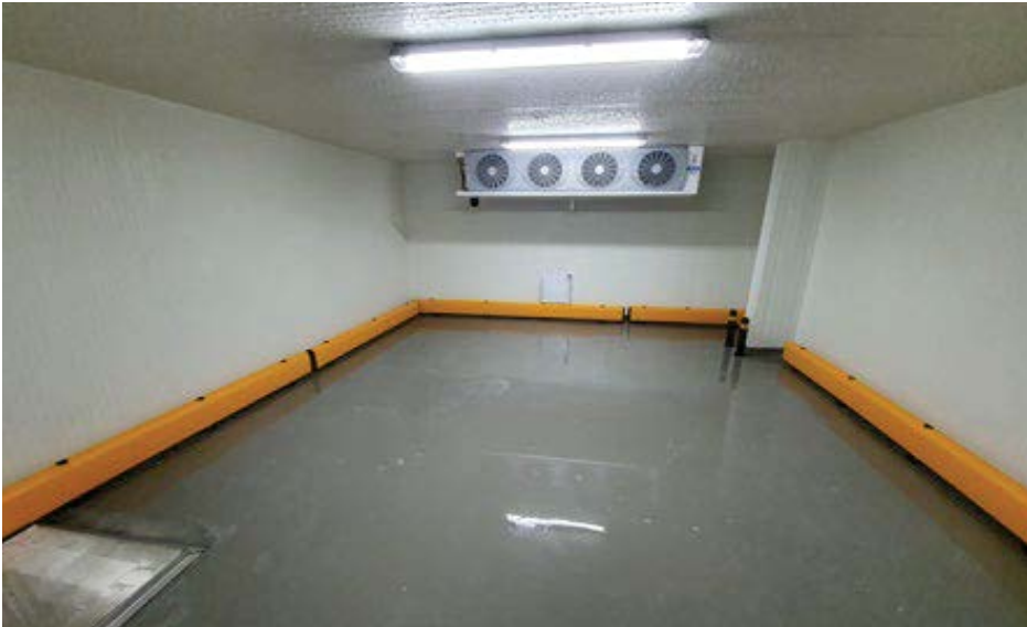
Sistema de Protección en Plantas Plant Security and Protection System
